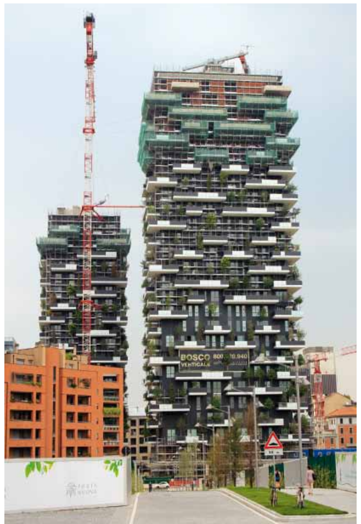
Mit dem grünen Wolkenkratzer in der italienischen Millionenmetropole Mailand wurde eine ökologische und nachhaltige Bauweise verwirklicht.
