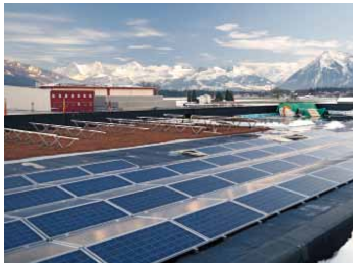
Aufbau eines EnergieGrünDachs bei den Firmen Contec/Crescendo/Coex. Im Vordergrund Flachpaneele Ost/West, kaum begrünbar; im Mittelgrund ausgeständerte Paneele Süd – ideal für differenzierte, artenreiche Begrünung
