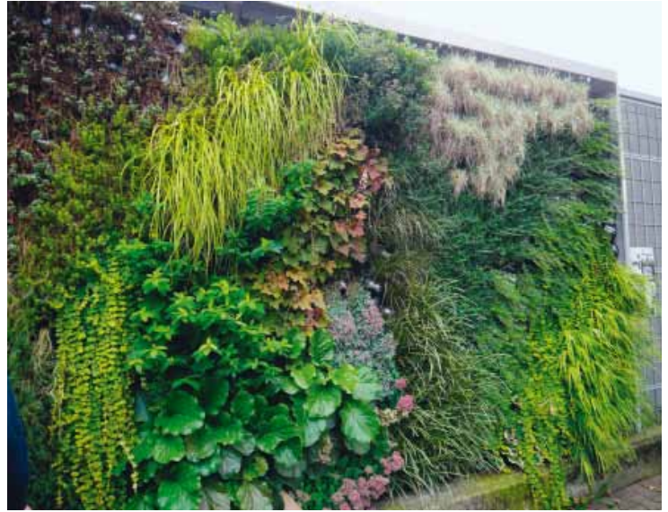
Fassadengebundenes Grün, mit Stauden, Gräsern und Zwerggehölzen gestaltet (Versuchsanlage Palmengarten Frankfurt am Main).
